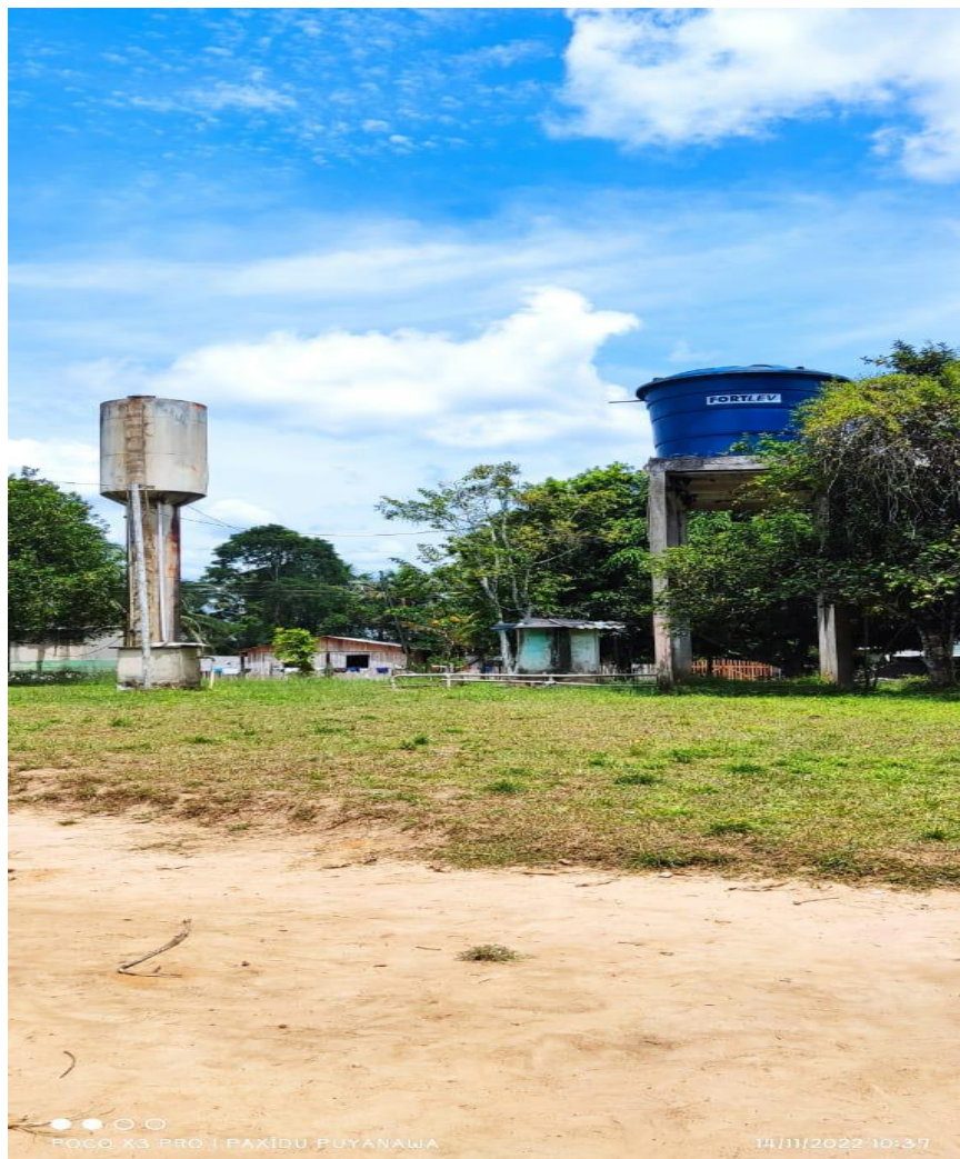
Foto 6: Sistema de abastecimento de água na aldeia Ipiranga. Fonte: Arquivo pessoal da pesquisadora. 2022.
