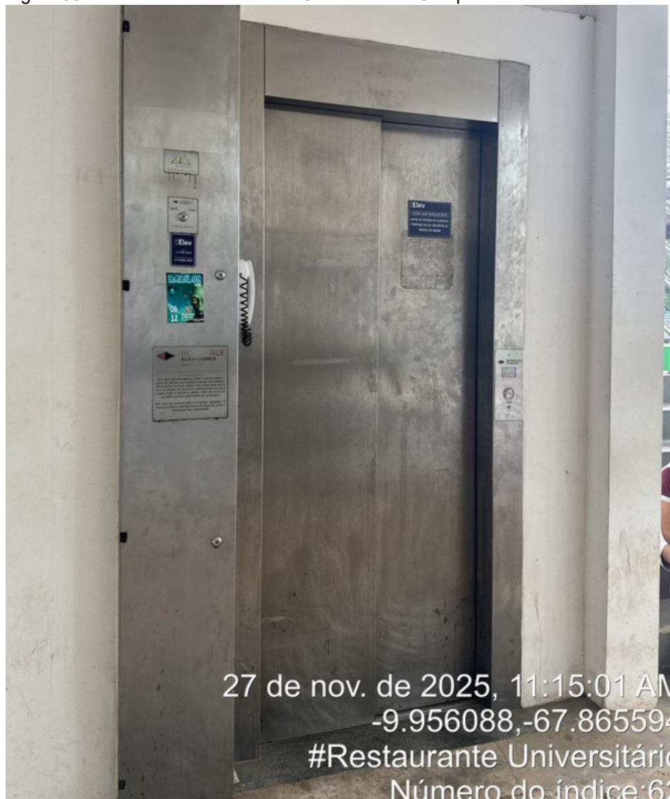
Figura 99 - Elevador do Restaurante Universitário - Campus Sede.
